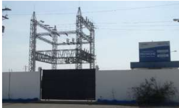
Ilustración 65: Vista de Subestación eléctrica Fundación Gestión & Desarrollo, 2020
