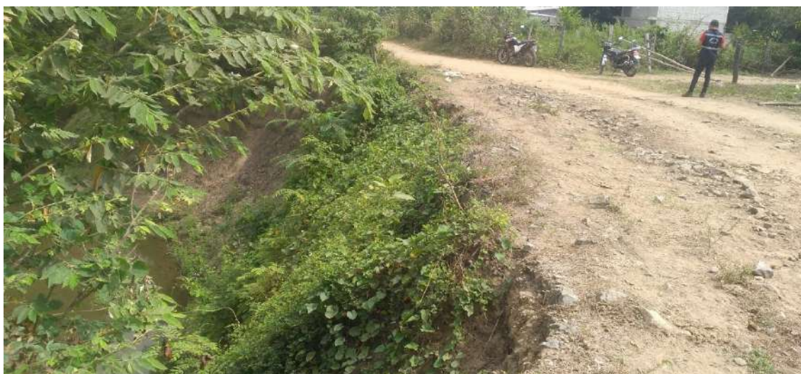
Fotografía 23.- Sector las iguanas en situación de riesgo por socavón sobre la vía.
