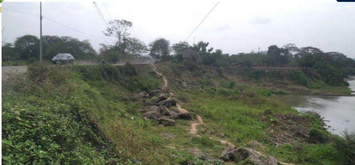
Fotografía 20.- Vía que conduce a la cabecera cantonal en situación de riesgo por socavón.
