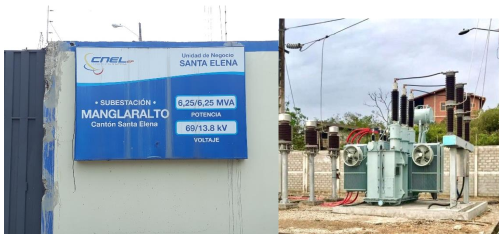
FOTO 19. Subestación de Reducción Manglaralto
