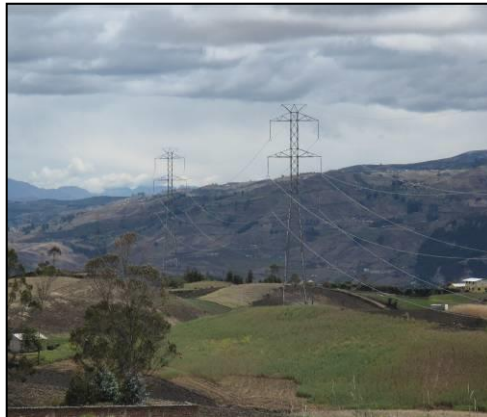
Foto 2.5.6: Línea de Transmisión de Energía
