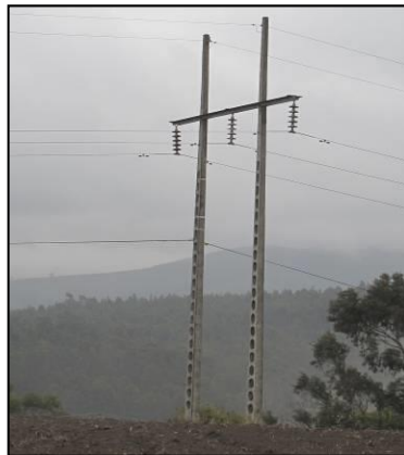
Foto 2.5.7: Sub-Línea de Transmisión de Energía
