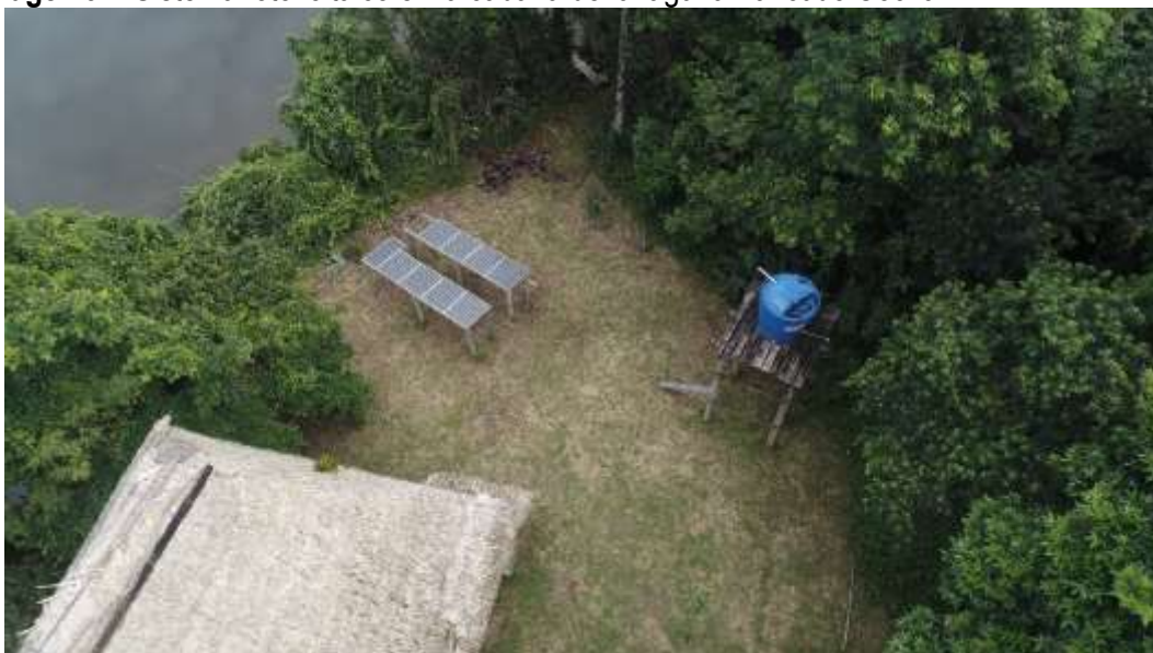
Imagen 9. Sistema fotovoltaico en la cabaña de la laguna Zancudo Cocha.
